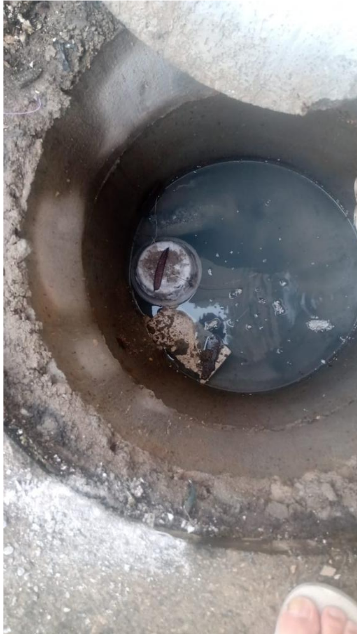
Foto 9: Falta de limpeza nas caixas de esgoto
