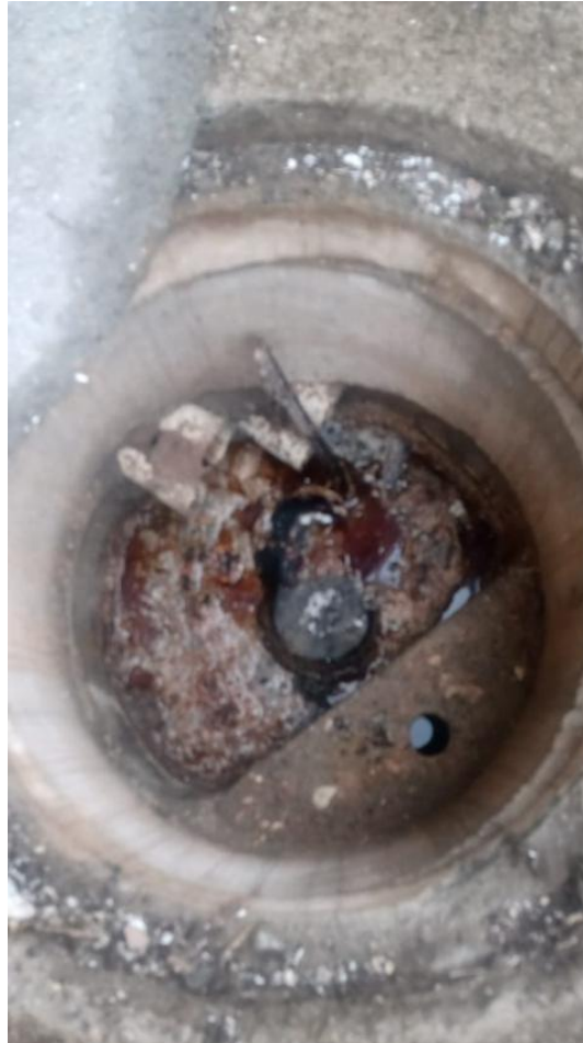
Foto 10: Resíduos nas caixas de esgoto
